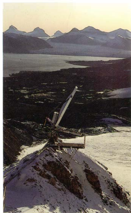
Antennemontering på luftmålestasjonen i Ny-Ålesund. Foto: Geir Aasebøstøl.
