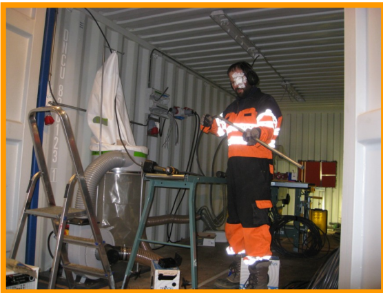
Her er den "enøyde" banditt Ivar, i full aksjon med å installere.
